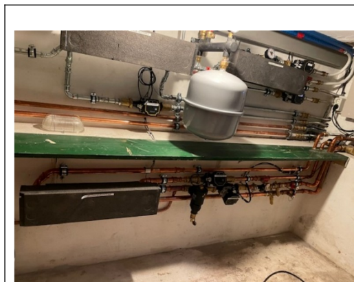
Indruk van een deel van het controlesysteem in de kelderruimte (enkele m2) met stahoogte onder de woonkamer.
