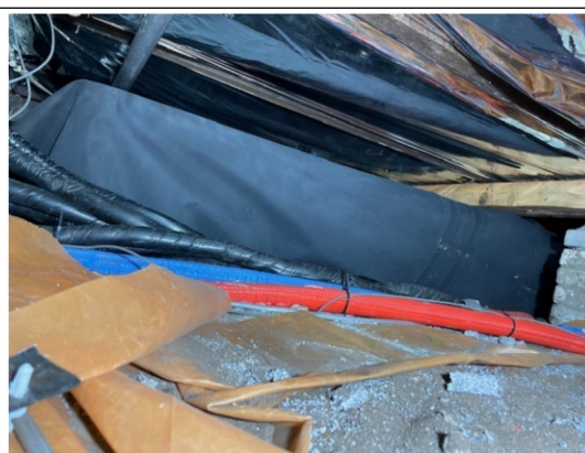
Indruk van hydrobag in de kruipruimte. Boven de Tonzon folie, onder de bodemfolie. Een goed gebruik van de ruimte.
